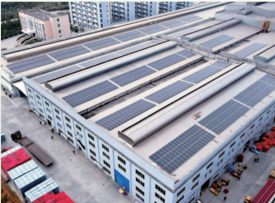
粵玻實業公司廠區屋頂光伏系統
